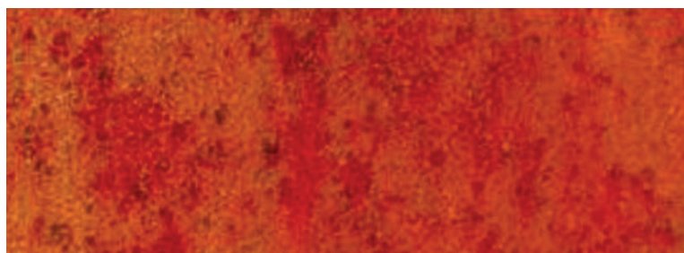
איור 9. קורטן בהחלדה מלאה
